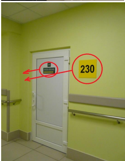
Рисунок 222. НЕПРАВИЛЬНО! В данном примере требуется перенести установленные информационные таблички на стену со стороны ручки двери
