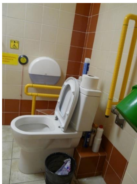
Рисунок 158. НЕПРАВИЛЬНО! Нарушены правила установки откидного поручня относительно края чаши унитаза
