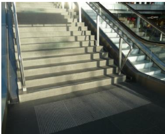
Рисунок 109. Решетка грязезащиты, выполняющая роль также и тактильной предупреждающей полосы перед лестницей.
