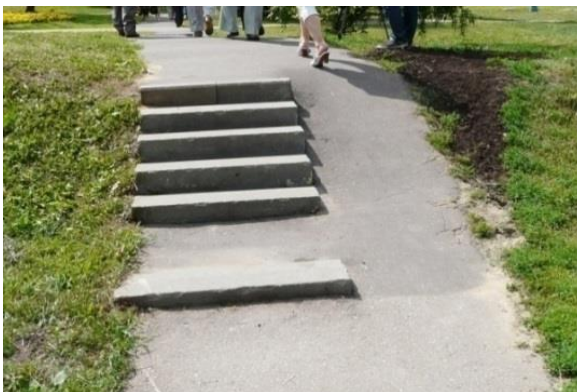
Уклон более 1:6, боковой уклон более 2%, отсутствуют бортик и поручни. Пандус не доступен.
