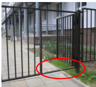
Недоступный проход для инвалидов на кресле-коляске. Требуется оказание помощи. Если на входе отсутствует вызывное устройство, объект недоступен.
